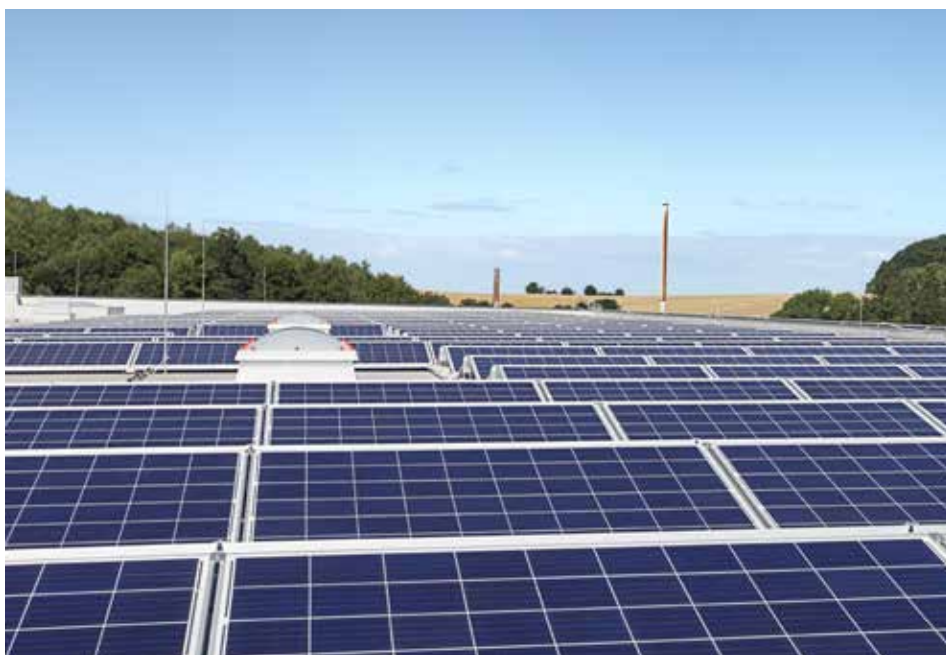
Zonepanelen op het dak van ons bedrijf.
